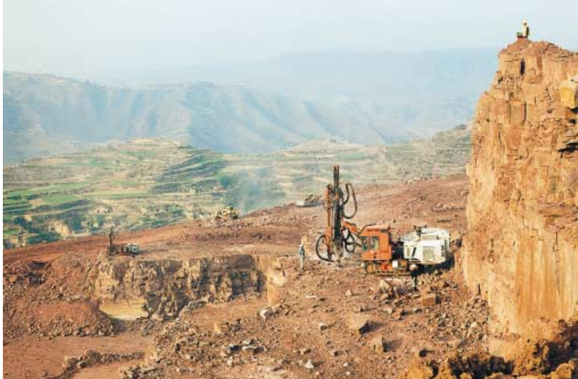
Vid Huang Ho-floden i Kina pågår ett av världens största entreprenadprojekt. För att bygga en ny vattenkraftsanläggning kommer 30 miljoner m 3 berg att brytas, till stor del med utrustning från Tamrock och Sandvik.
